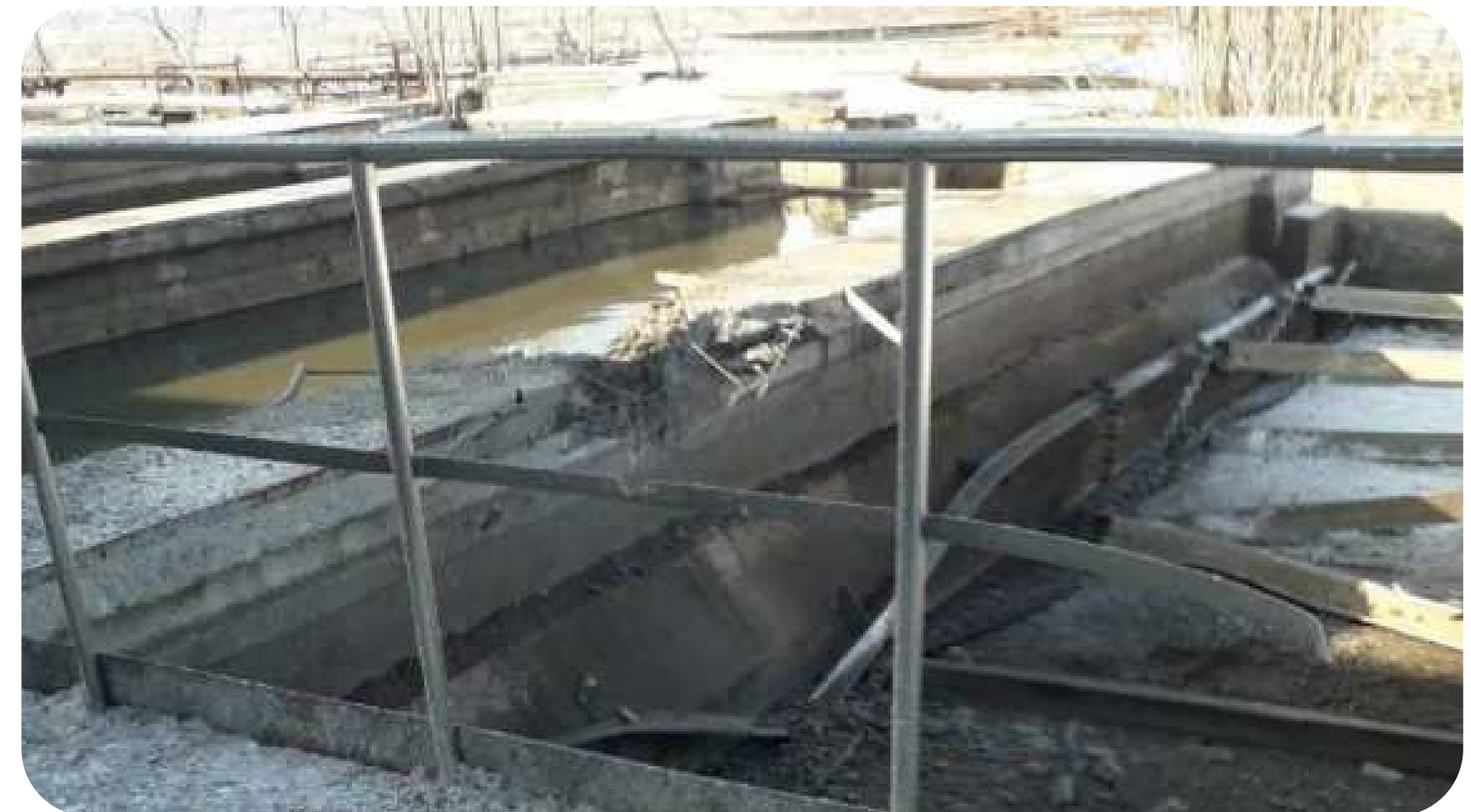
Заброшенные очистные сооружения в г. Васильевка Запорожской обл. Фото: t.me/vodokanal
